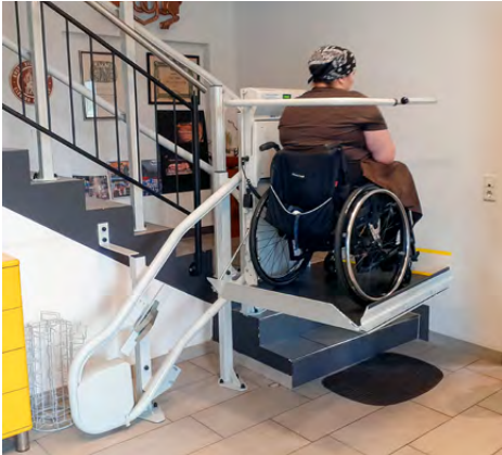
Ein Treppen-Lift zum Pausenraum
